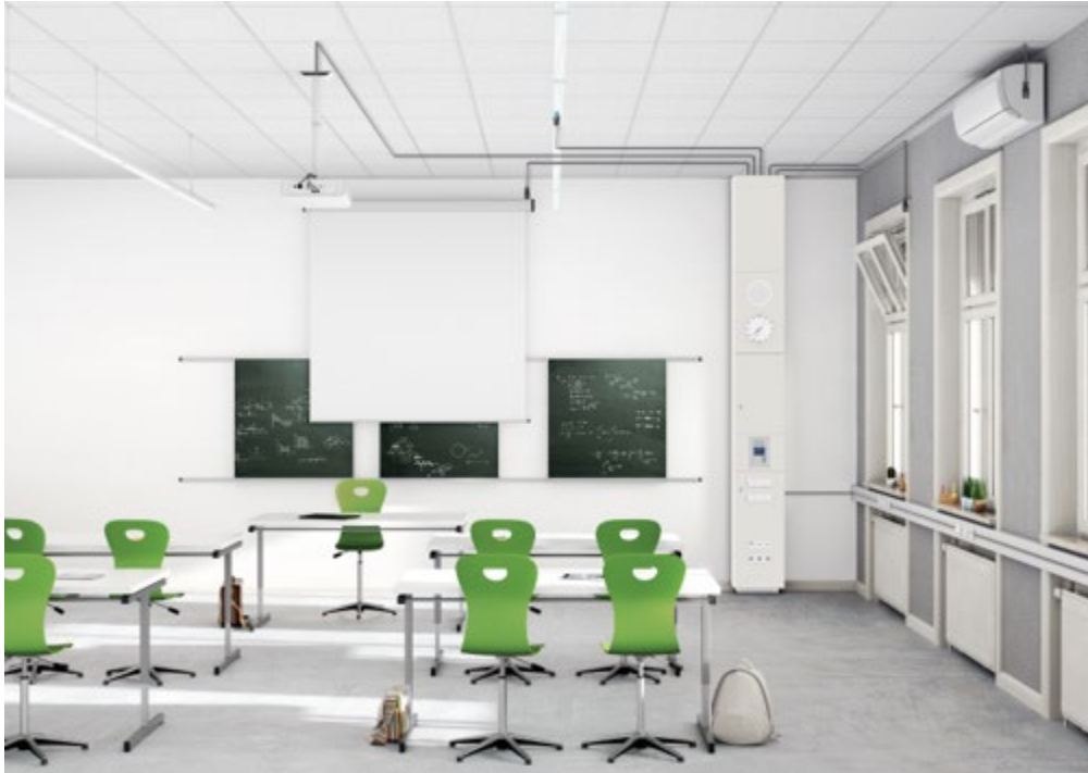
Foto 1 (gesis®-Installationssäulen im Klassenzimmer)
