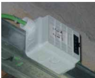
Instalación sobre bandeja
